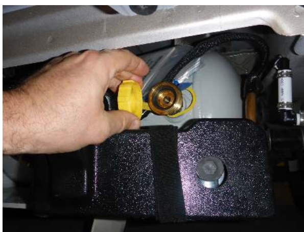
Propane fill valve
